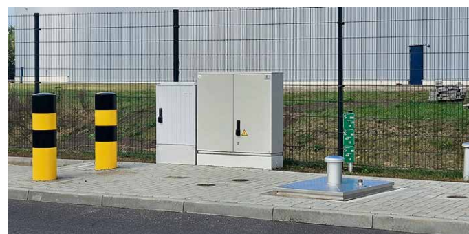
Das neue Pumpwerk am Gewerbegebiet „Auf der Heide“.
